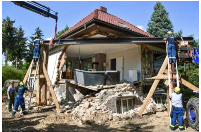
Gebäudeeinsturz in Schulzendorf
