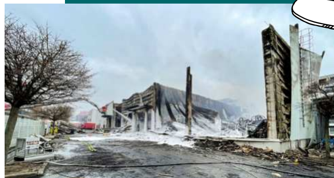
Brand in einer Lagerhalle in Köpenick
